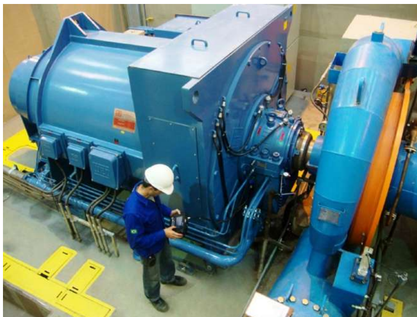
Figura 4 – Hidrogerador em operação.
