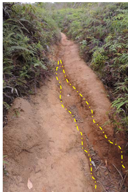
b. Erosão em ravinas
