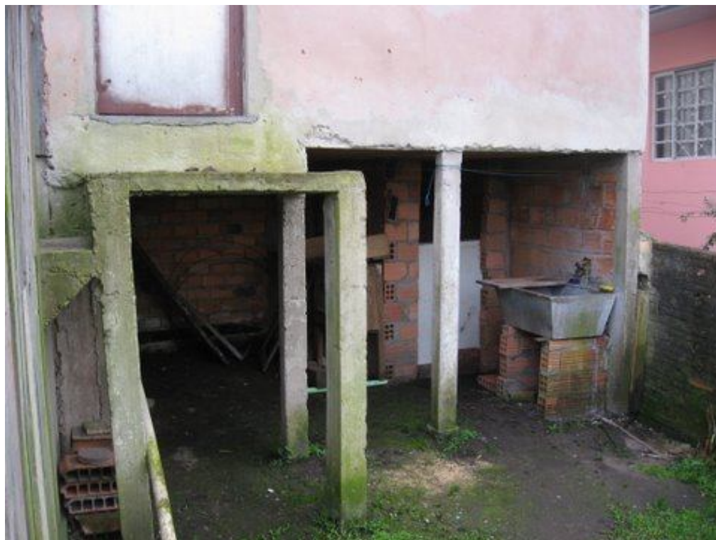
Figura 5 - Casa 02, lado direito, porão úmido e com pouca luminosidade.
