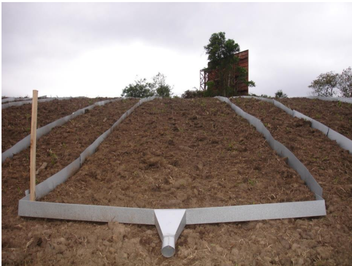
Figura 2 - Chapas divisórias e calha coletora de enxurrada.
