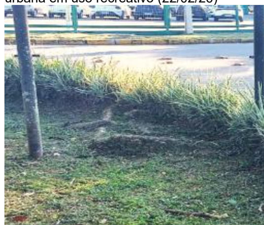
Detalhe da calçada sem pavimento (07/10/24)
