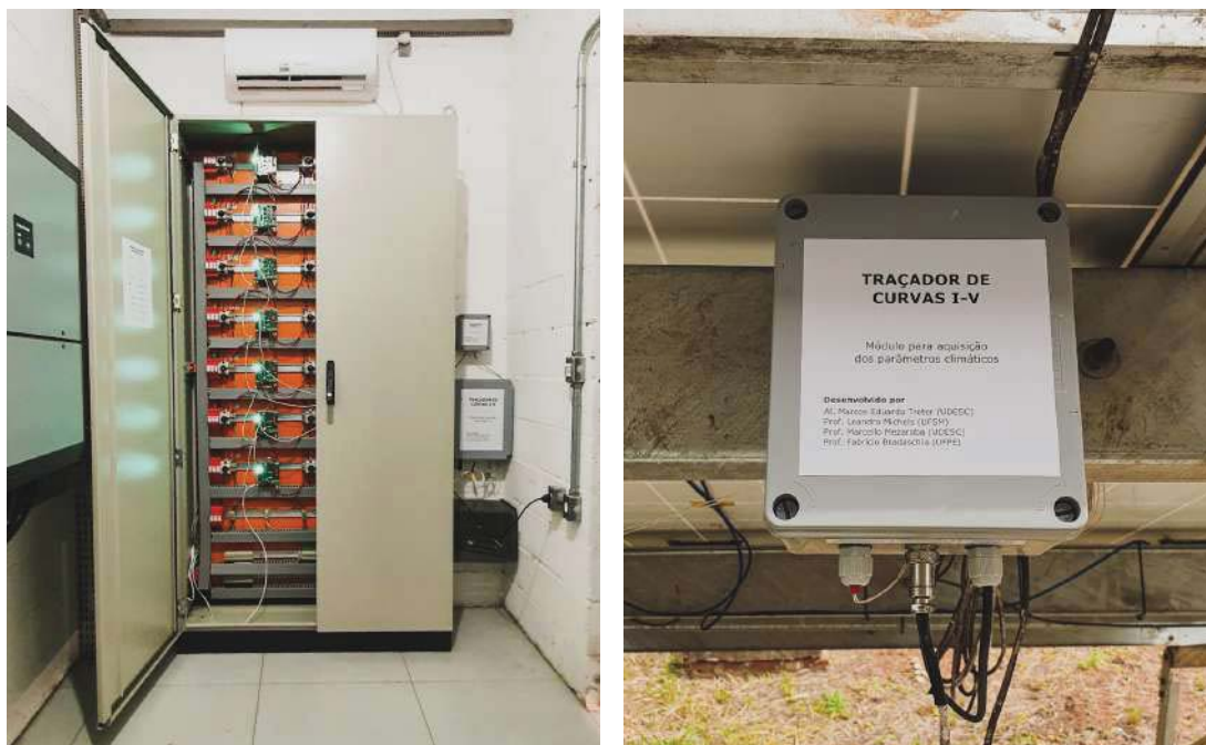
(a) Painel de conexão das séries FV.
