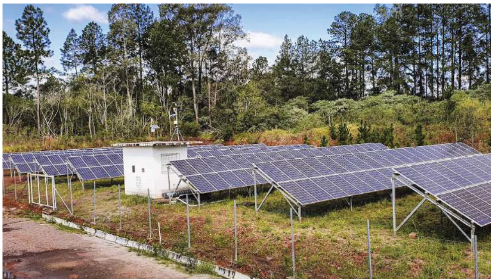
Figura 53 – Usina fotovoltaica localizada na Universidade Federal de Santa Maria.
