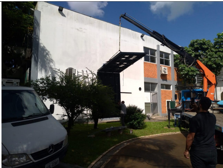
Instalação Telão LED
