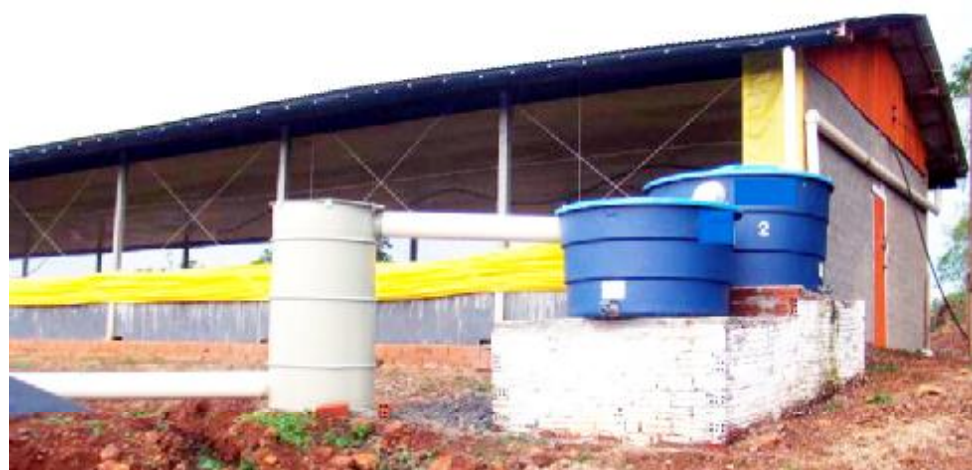
Sistema de filtragem com caixa de descarte da primeira água, pré-filtragem e filtragem
