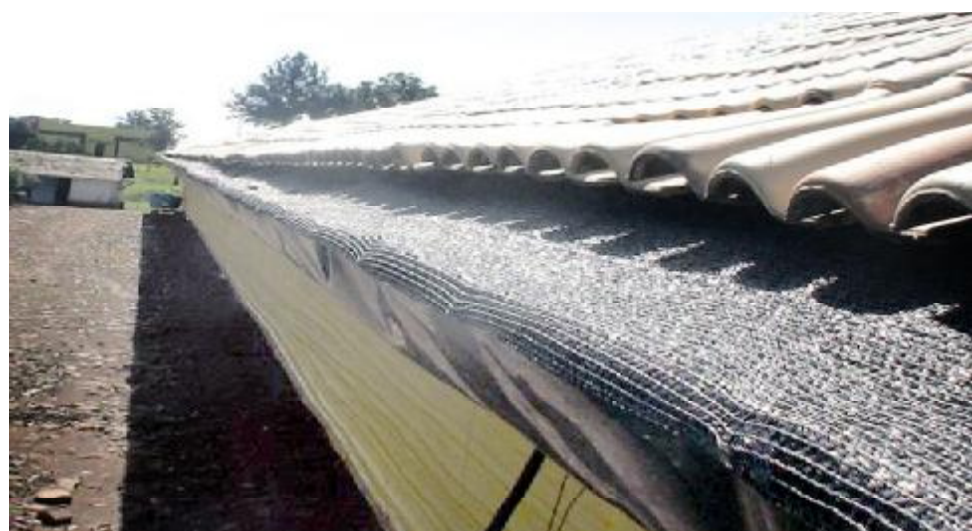
Detalhe da calha de captação da água da chuva que cai sobre o telhado, com proteção de tela para filtragem de partículas maiores (folhas, galhos...)
