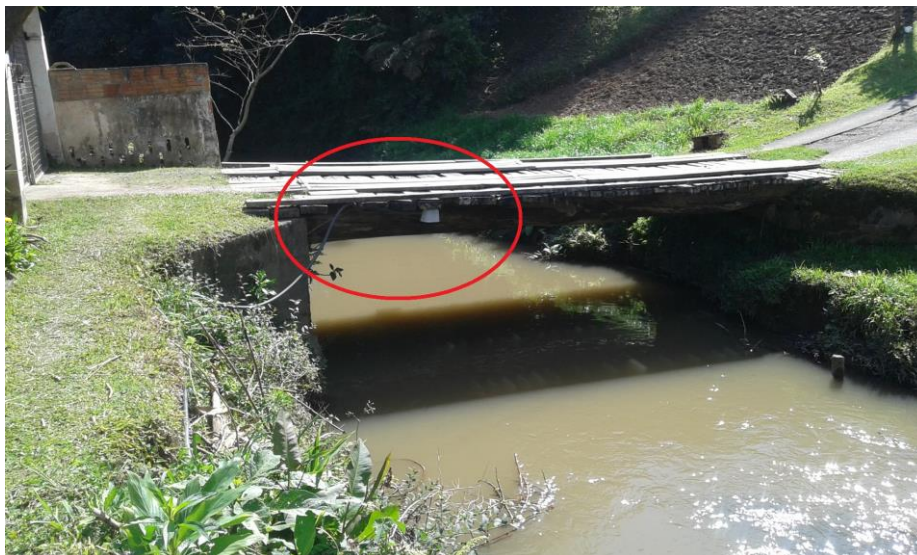
Figura 4 Estação de monitoramento fixada
