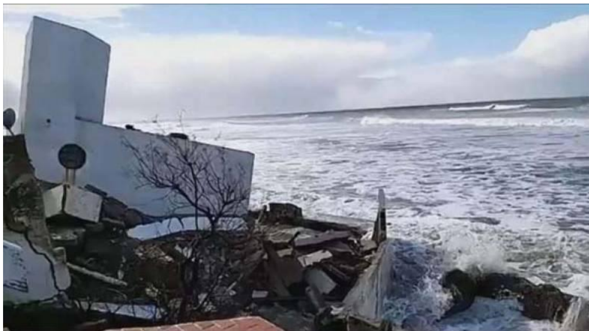
Figura 20. Edificação destruída por força da maré no Mar de Ajó na Argentina.
