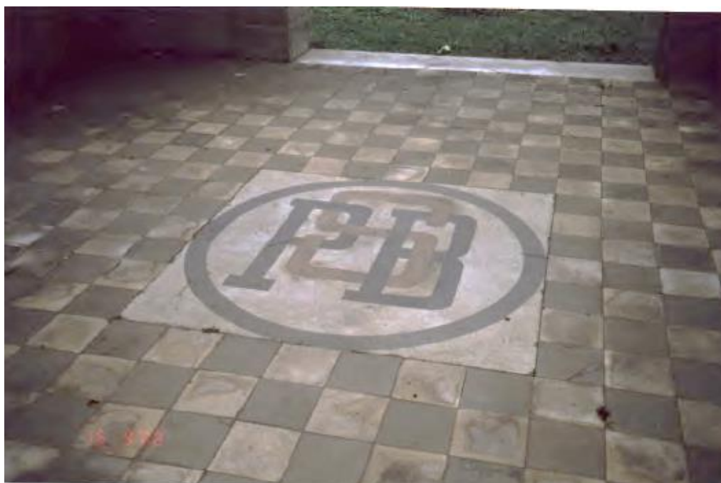
Figura 14 - Imagem de vistoria de estudo de tombamento: piso do pavilhão central da pérgula
