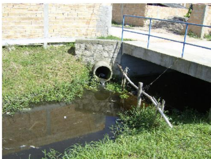
Figura 11 - Vala do Juca e o despejo irregular de esgoto no rio
