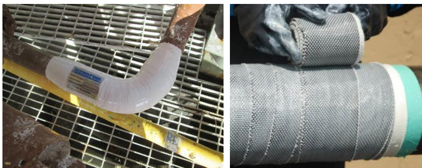
Figura 1. Exemplos de reparos compósitos em tubulações corroídas (Fonte: Tecnofink)
