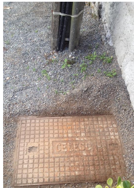
Caixa de Passagem junto ao Poste
