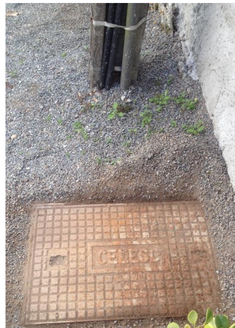
Caixa de Passagem junto ao Poste
